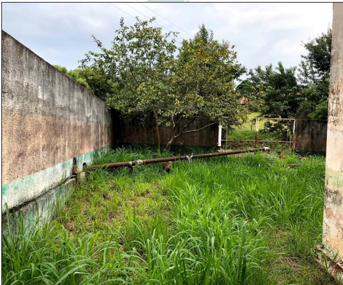
Figura 20 – Poço 01 com tubulação de recalque
