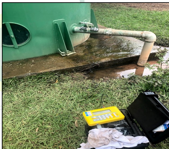
Figura 43 – Tubulação de saída do Res.04 para a rede
