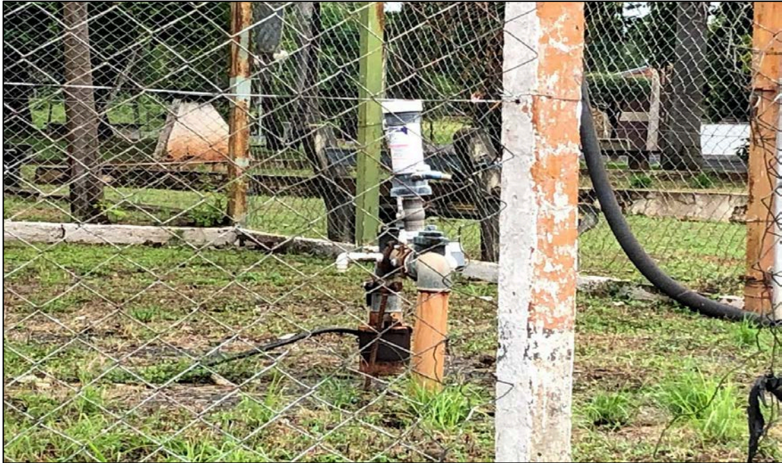
Figura 31 – Detalhe do Poço P-03
