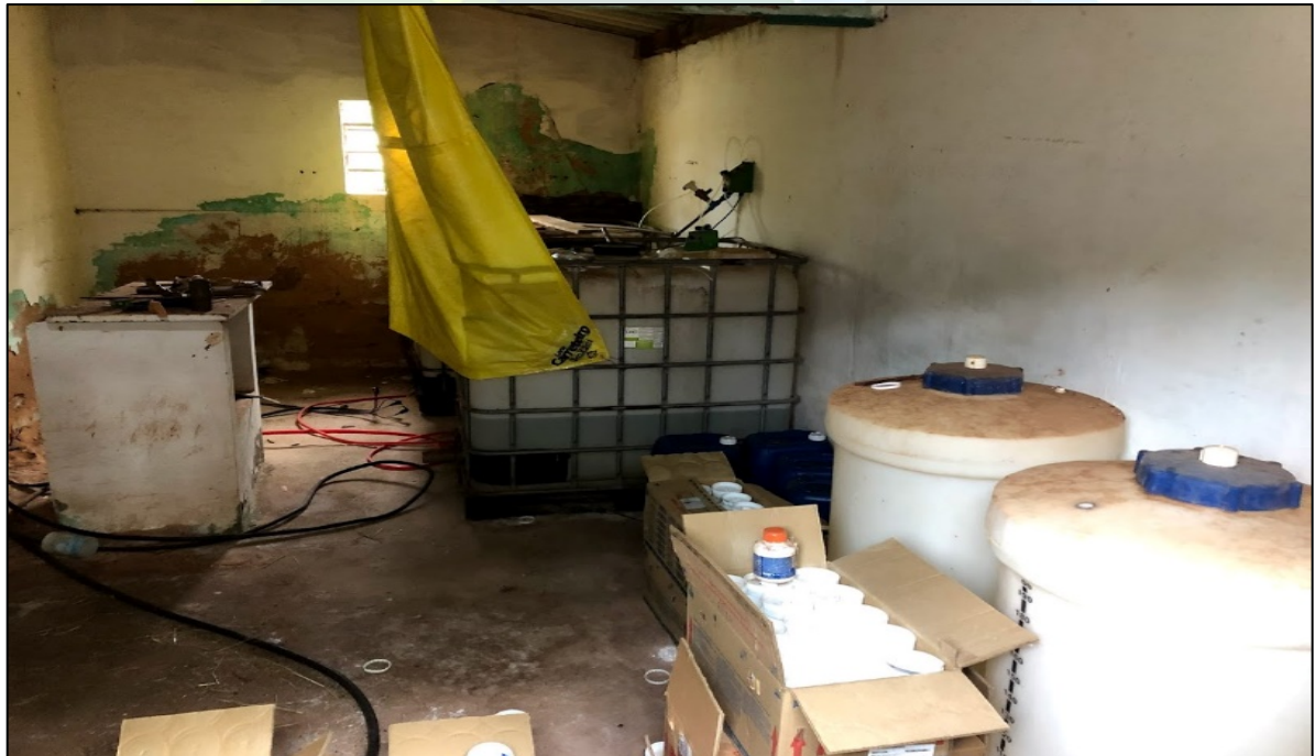
Figura 22 – Casa de tratamento do Poço P-01
