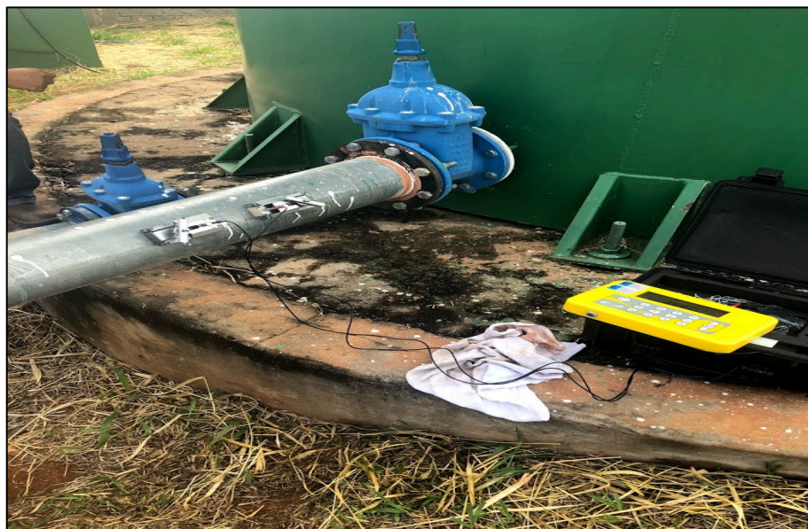
Figura 44 - Tubulação de saída do Res.05 para a rede
