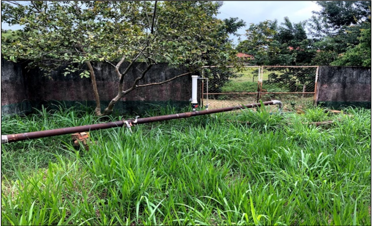
Figura 21 – Detalhe do Poço 01 com tubulação de recalque
